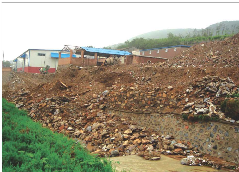
中门寺冲毁的挡土墙
