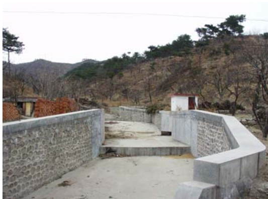
怀柔张台子沟道控制站
