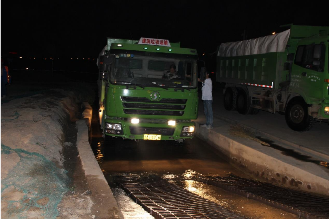
图 6.2-1 工程车辆冲洗废水收集设施
