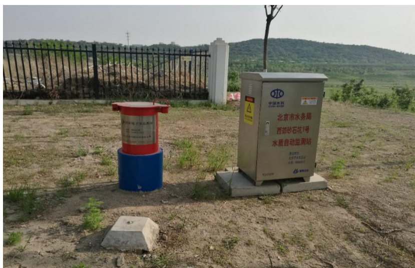
图 8.2-2 阜石路砂石坑地下水自动监测井
