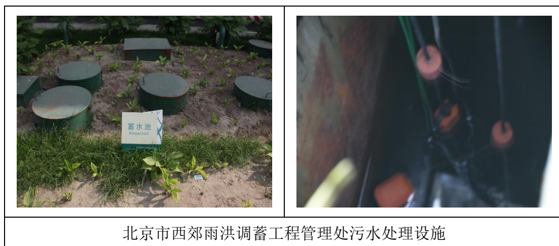
图 6.2-2 运行期污水处理设施
