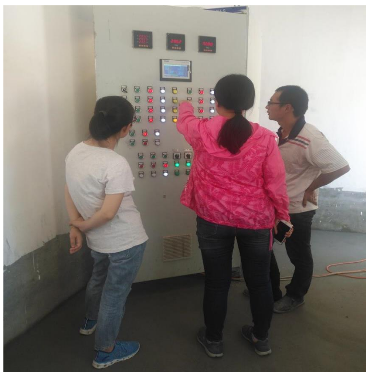
(a) 现场 PLC
