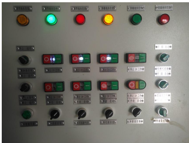
(c) 现场 PLC
