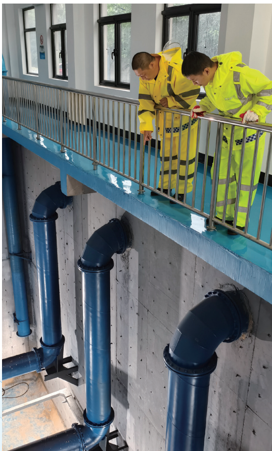
房山区水务局职工查看排水泵站运行情况。
